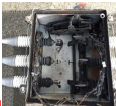
〔落雷による焼損〕 上：外観 下：内部
