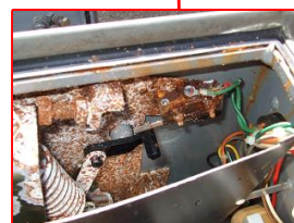
〔PAS設置後20年経過〕 内部浸水、稼働部に錆
